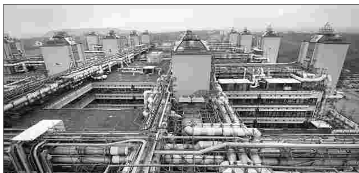
Wie von der Brücke eines Tankers ist der Blick von den Versorgungstürmen über das Dach des Uniklinikums. Viele Rohre werden nach dem Umbau verschwunden sein. Foto: Harald Krömer
