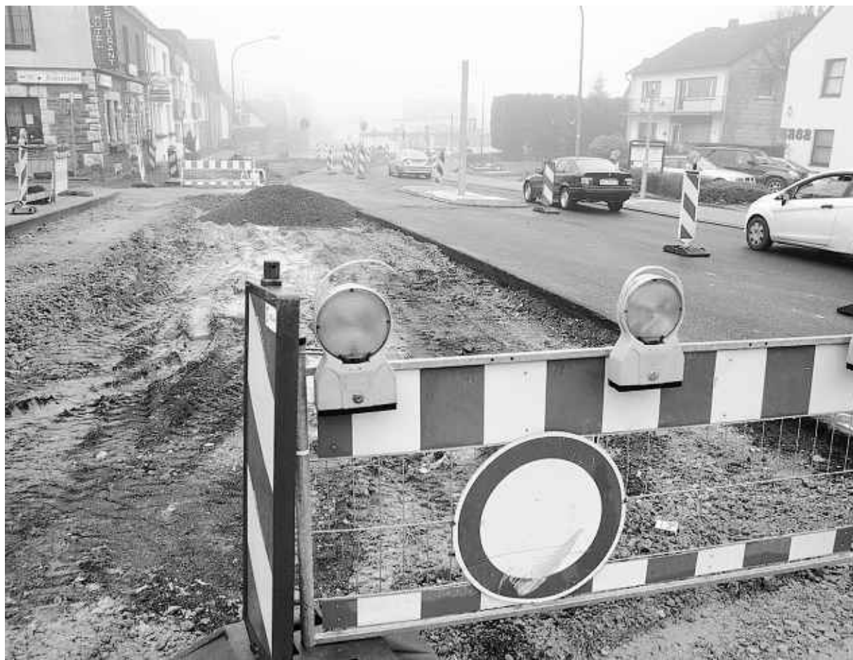
Nicht schlechtes Wetter war der Grund dafür, dass an der Baustelle in Imgenbroich auch gestern die Arbeit ruhte. Ein fehlerhaft verlegtes Kabel hatte einen Baustopp zur Folge. Foto: P. Stollenwerk
