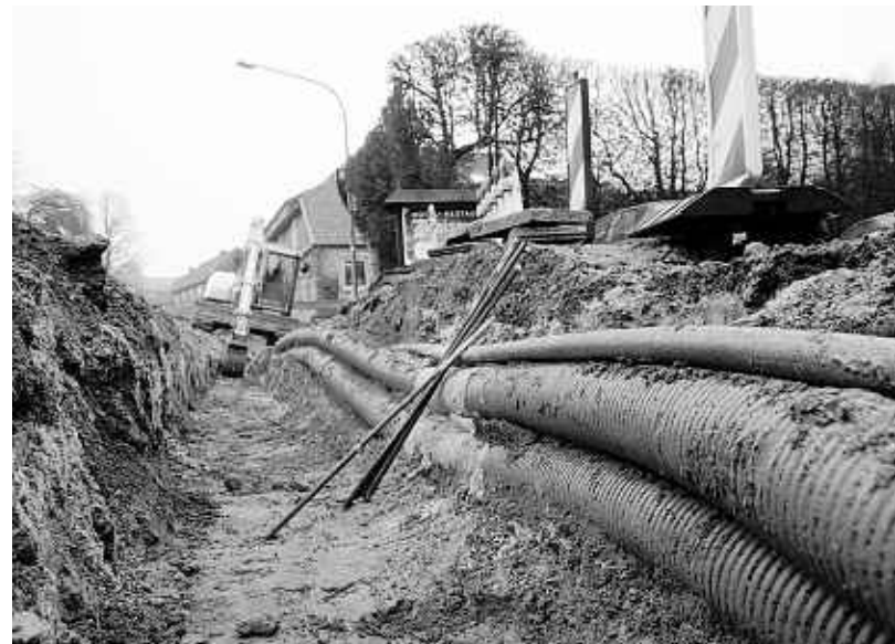
Hier liegt das Problem: Das Kabel vom Windpark Höfen muss tiefergelegt werden. Foto: P. Stollenwerk
