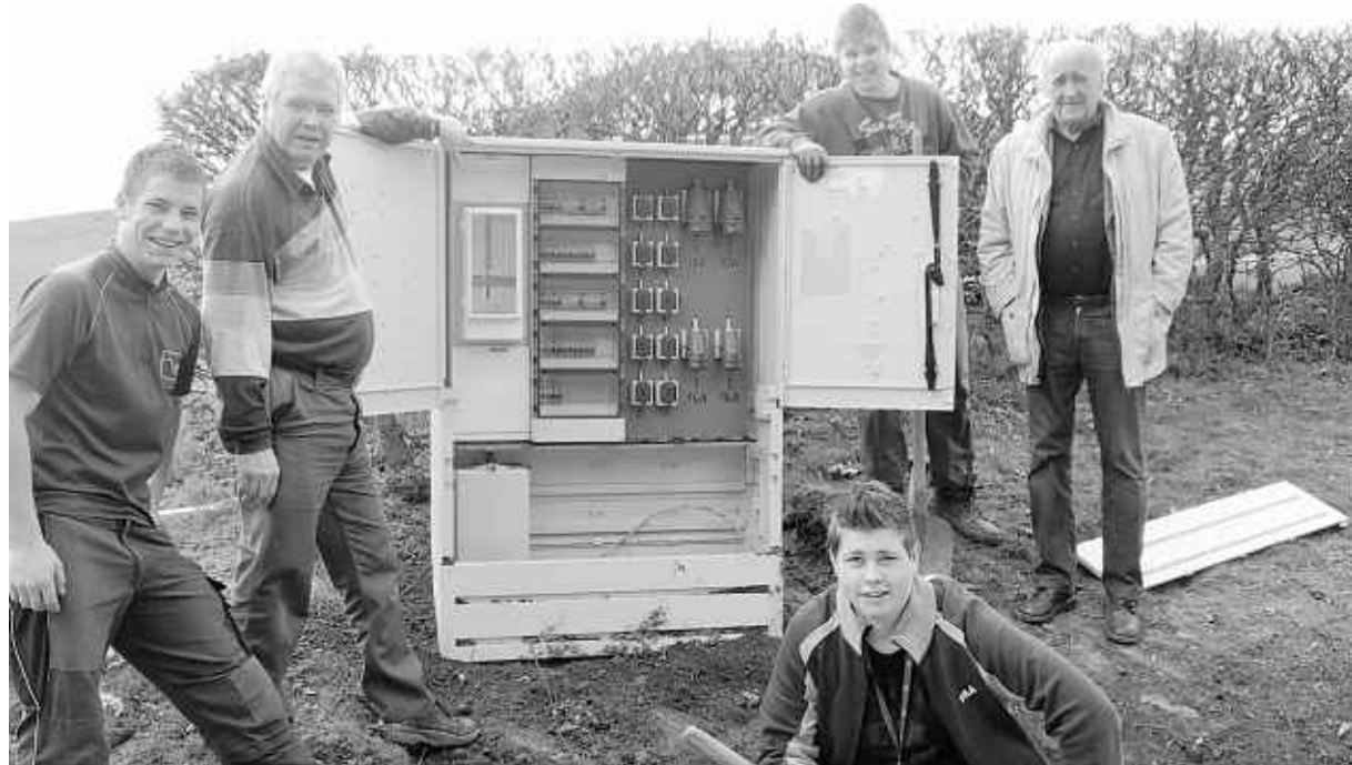
Mit vereinten Kräften wurde am Festplatz in Dedenborn jetzt eine stabile Stromversorgung für Großveranstaltungen installiert.
